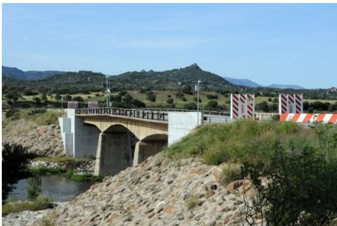
Il ponte di Oloè, crollato nel 2013, rifatto e nuovamente chiuso (foto massimo locci)
