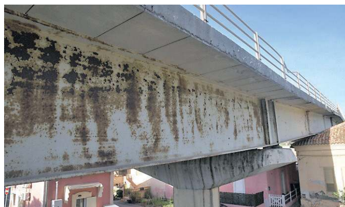
Un ponte in pessime condizioni a Golfo Aranci
